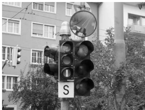
写真-5 トラムに対する優先信号現示 (左側がトラムに対する進行現示、 右側は自動車に対する停止現示)
