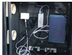
カメラの付帯設備
